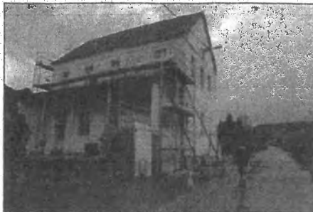
L'école était en travaux au moment des faits après avoir été endommagée par un incendie. Archive Progrès/Philippe TRIAS
